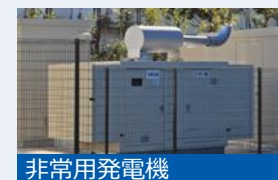
非常用発電機
