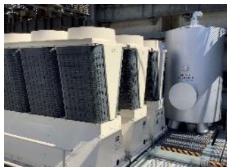
ラグザ大阪熱源更新工事による エネルギー使用量削減
