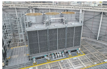
HEPファイブ冷却塔更新による 水消費量の削減
